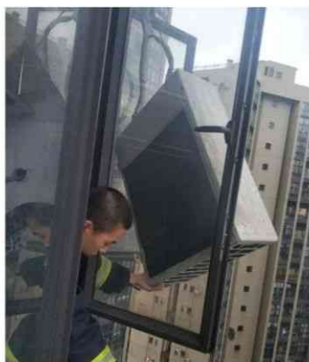
一业主家中的空调室外压缩机在狂风中突发脱落，危险万分。救援人员立即配合消防人员进行高空室外作业，及时排除重大安全隐患。
